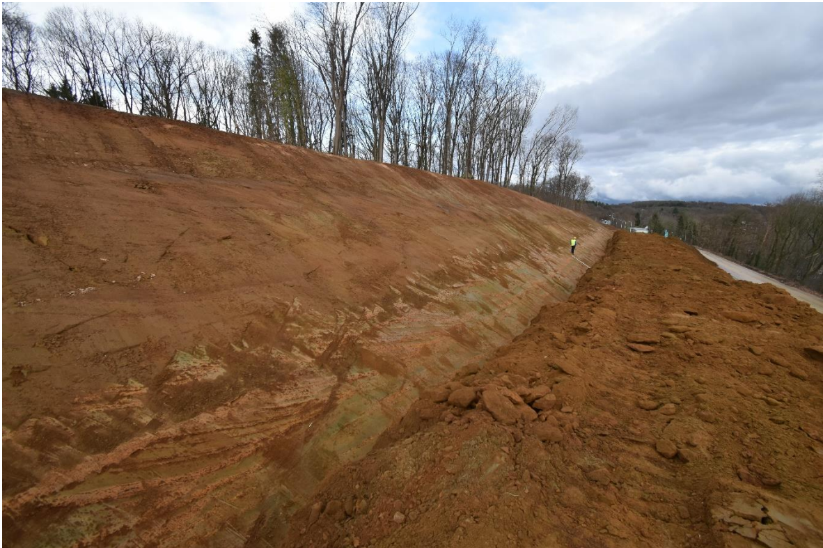
Figuur 4. Overzicht langs wand 3, foto richting oosten. Het betreft een nieuw afgegraven talud waar onderaan in het vers afgeschraapte deel de sedimentaire structuren duidelijk zichtbaar zijn. Foto F_ VLA17-4-1-006-W3-06.
