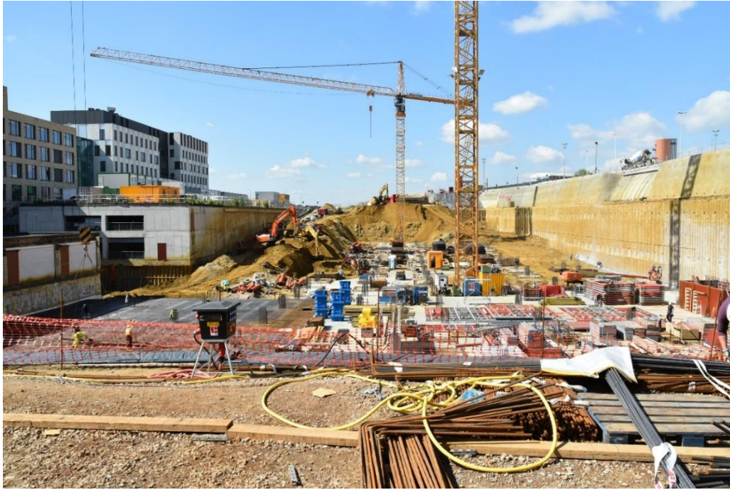
Figuur 3. Overzicht van de bouwput op 03/05/2018. Foto genomen vanaf de noordoostelijke wand, richting zuidwesten. (F_VLA17-4-1-001-OV-01)
