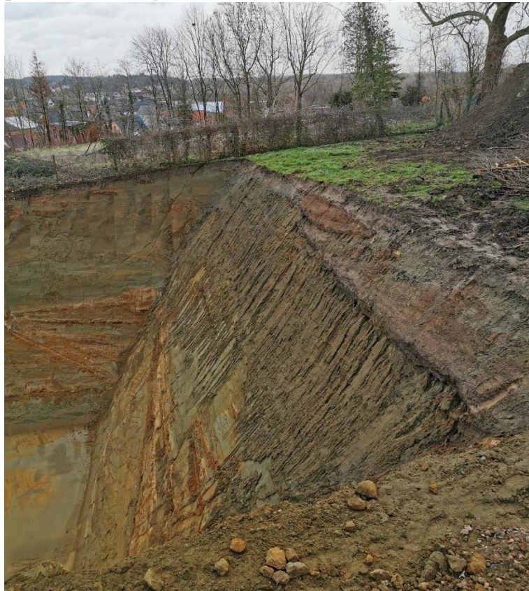
Foto 3. Rakelings zicht op zuidelijke ENE-WSW gerichte bovenwand van de bouwput. Op de voorgrond bovenaan een donkere vegetatielaag onder colluvium rechtstreeks onder het Zand van Diest. De wand in het Zand van Diest onder het colluvium is besmeurd met aflopende bruine leem.
