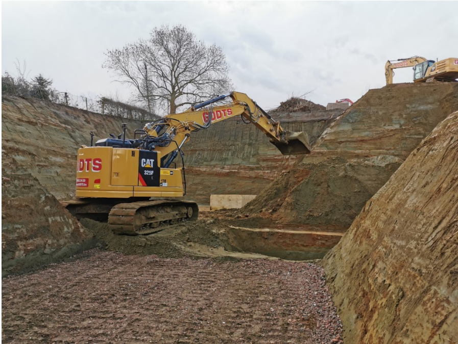
Foto 4. Zicht vanaf de noordelijke ingang van de bouwput met op de achtergrond de hoge zuidelijke achterwand van de bouwput.
