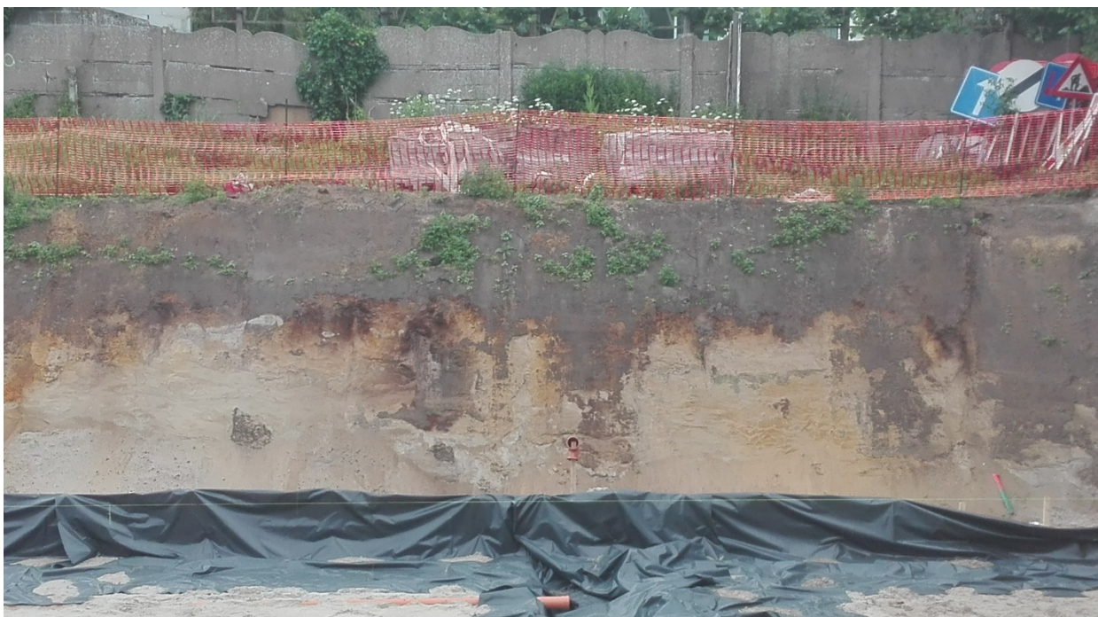
Noordoostelijke wand van de bouwput, parallel aan de Kasteelstraat, met roestverkleuring onder de door zwarte grond besmeurde zone, vage gestoorde
