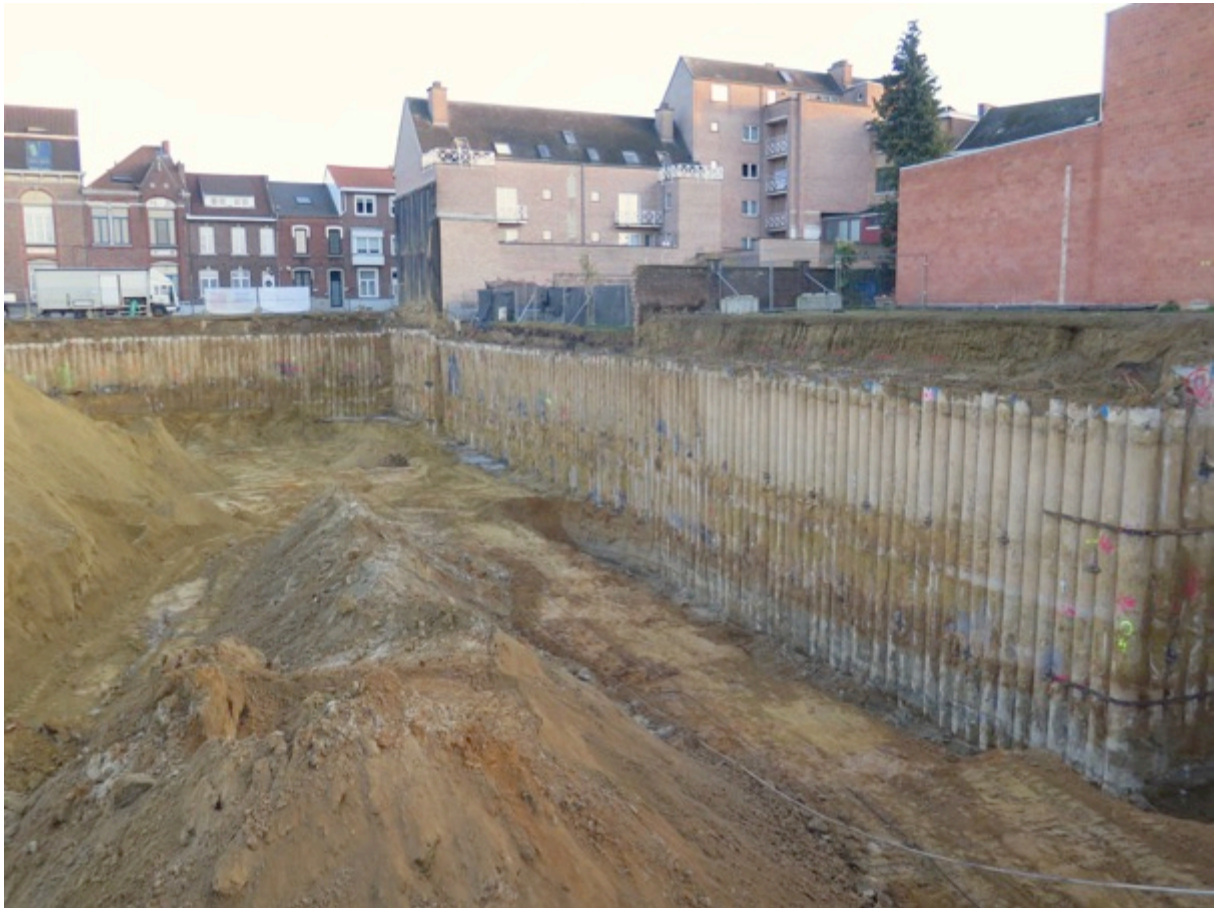
Foto 8 – zicht op zuidwand van bouwput met duidelijke horizontale gelaagdheid binnen eenheden B en C. Mooie kleurafwisseling (door relictten van sedimenten op beton) en zeer duidelijke bruinrode geoxideerde band (schommelingszone grondwatertafel?) vlak boven kleurijkere sedimenten. Volgende foto's zijn details van deze wand (midden van foto)
